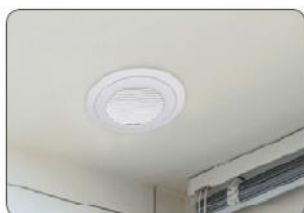
BOUCHE D'INSUFFLATION/REPRISE INSTALLÉE
